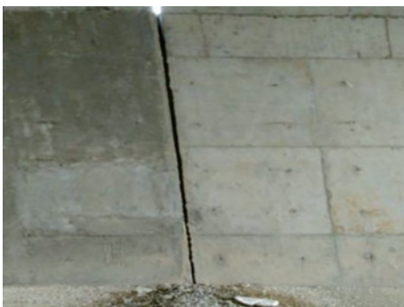
图3 涵洞伸缩缝裂缝宽10 cm
