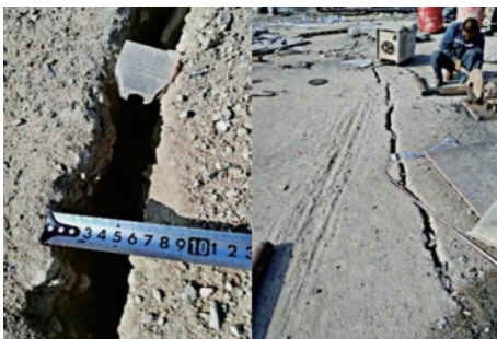
图2 路基纵向贯通裂缝宽1~7 cm
