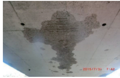
图15 第2跨底板大面积露筋
