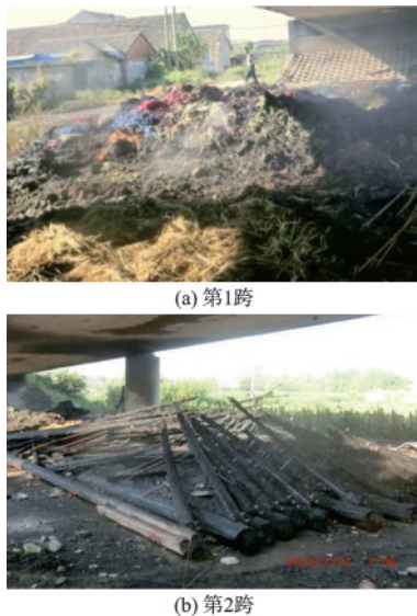
图2 受火桥跨灾后残余燃烧物
