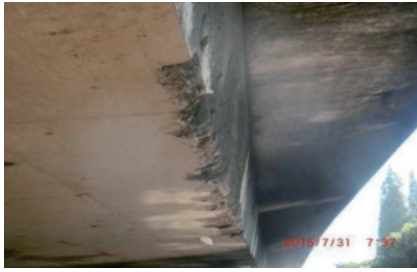
图14 底板与腹板角点处破损严重
