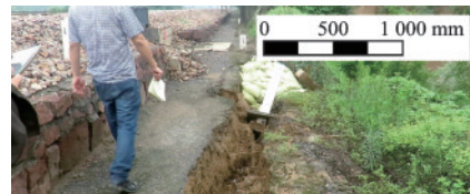
图3 铁路水害沿线某路堤滑坡后缘拉张裂缝
