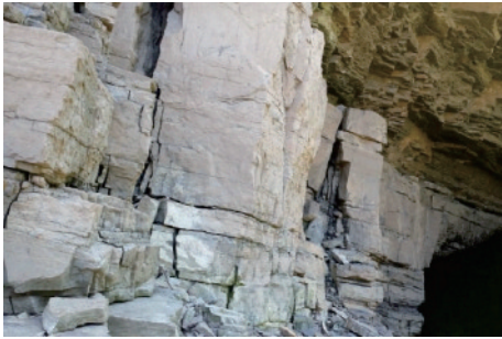
图4 棺木岭基座岩体压裂破碎
