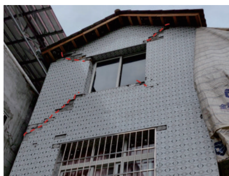
图9 墙体裂缝(美罗镇,Ⅶ度)
