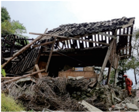
图 13 木结构严重破坏(得妥镇,Ⅶ度)
