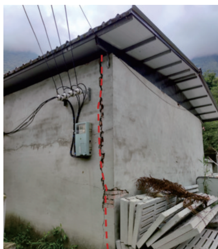
图8 竖向裂缝(磨西镇,Ⅸ度)
