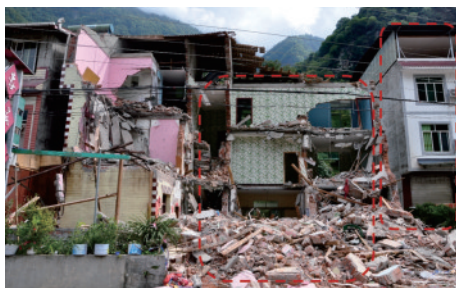
(a) 局部倒塌(草科乡田湾河村, VII度)
