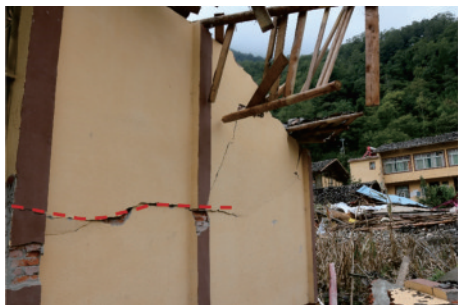
图7 水平裂缝(磨西镇,Ⅸ度)
