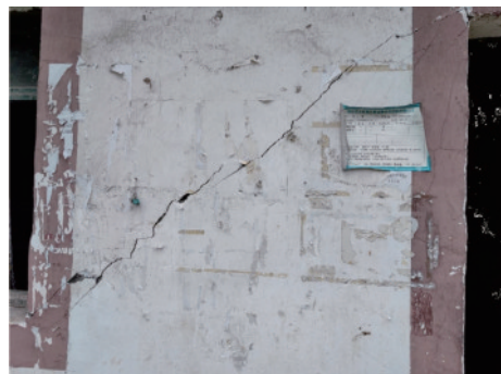
(a) 单向斜裂缝(美罗镇, VII度)
