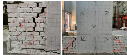
(a)窗下墙裂缝形态 (b)整体破坏形态
