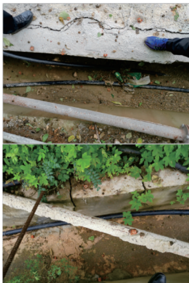
图2 缓坡后缘截排水沟裂缝发育情况
