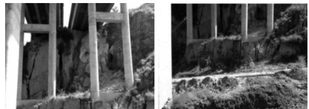
图4 高陡边坡水毁崩塌
