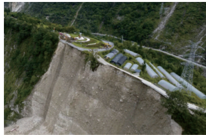
(b) 贡都曲线弯路处路堤边坡崩塌
