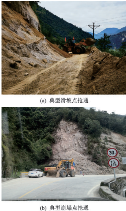
图6 省道S211线王岗坪方向震后应急抢通
