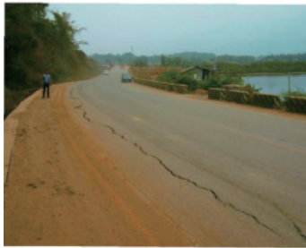
(d) 沥青路面弯转处被液化的基础拉裂
