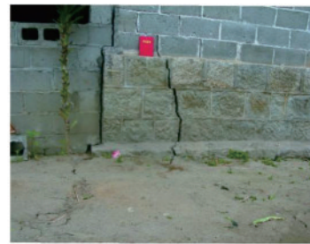
(c) 液化引起的贯穿地面与墙体的裂缝
