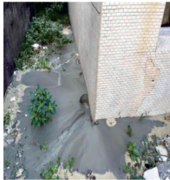
(a) 土壤液化,房屋裂缝喷泥沙
