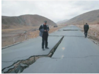
(b) 液化导致的扎曲北侧公路路基变形
