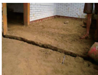
(a) 板桥镇兴隆村地表喷出物-粉砂
