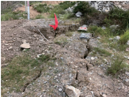
图10 滑坡后壁拉张裂缝
