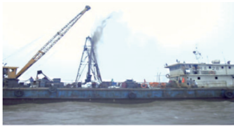
(a) CZHY18号钻孔浅层气喷发实景
