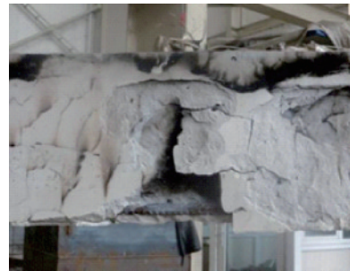
图10 高温作用下的破坏 Fig.10 Damage under high temperature
