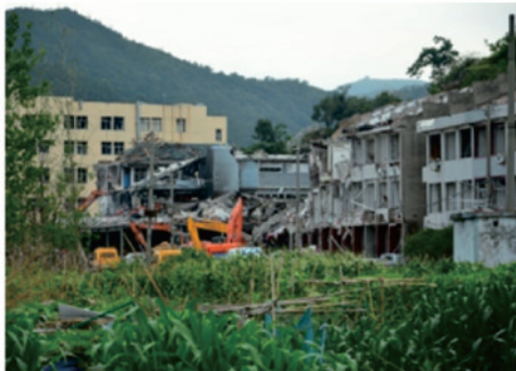
图5 居民楼墙壁和屋顶受损(145 m)
