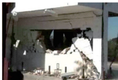
图7 填充墙的存在使得框架柱发生压剪破坏 [68]
