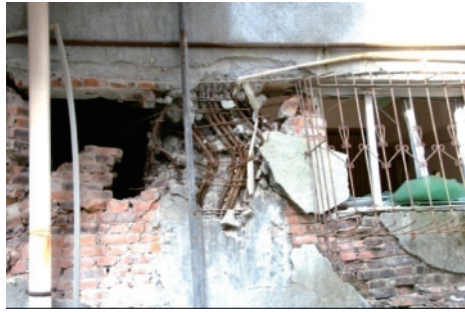
图 5 洞口设置不当使得柱发生短柱破坏
