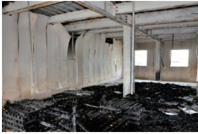
图10 火灾后试验现场(A柱侧视角)
