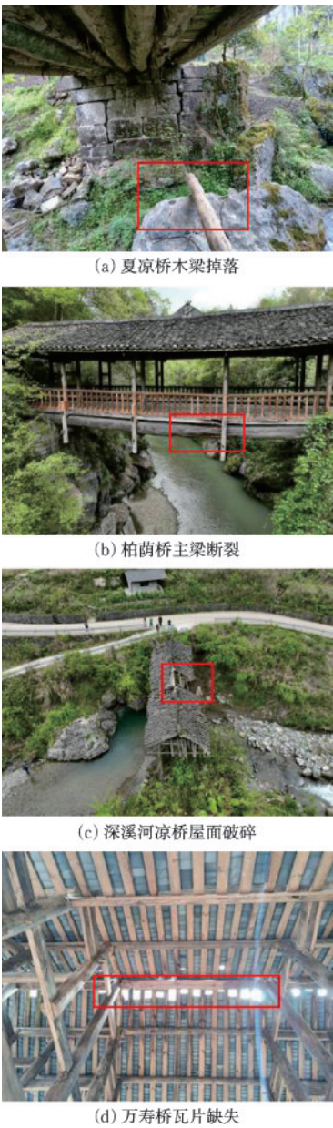
图7 部分损毁廊桥示
