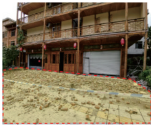
图4 屋顶覆盖材料坠落
