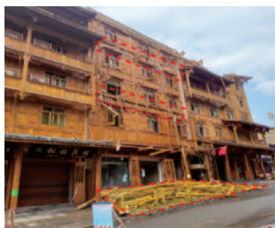
图5 窗户屋檐覆盖材料坠落
