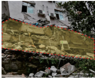
图3 外围护墙破坏坠落
