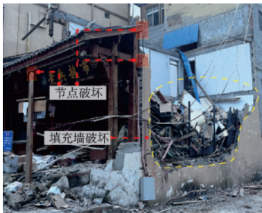
图10 建筑B的震害
