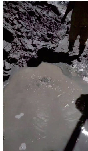
图10 J7井基坑涌水照片(15m深处)
