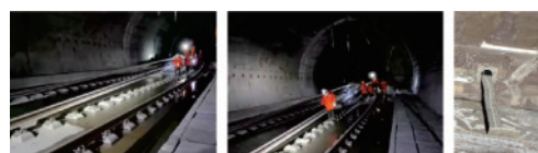
图1 大梁隧道震害
