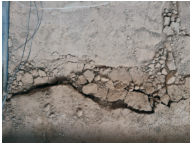
图8 加载0.6g Z向坡脚裂缝发育
