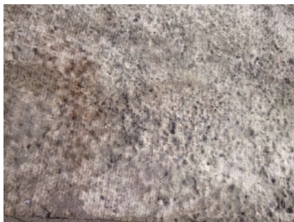
图 8 现场碾压后颗粒型双层无纺布 GCL 的破坏情况
